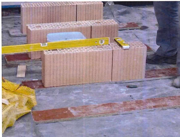
Photo 2 : première couche de pierres posées à niveau, les unes à côté des autres, sur la planche
