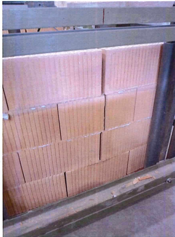
Photo 11 : BH5 après rupture
